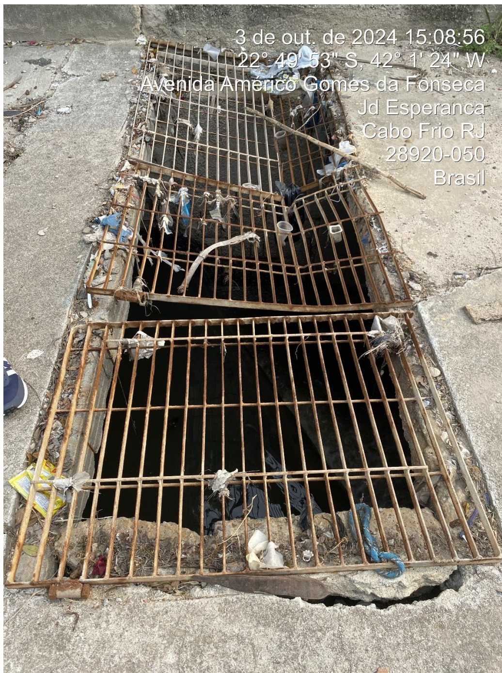
Figura 93 – Condições críticas da estrutura física do canal.
